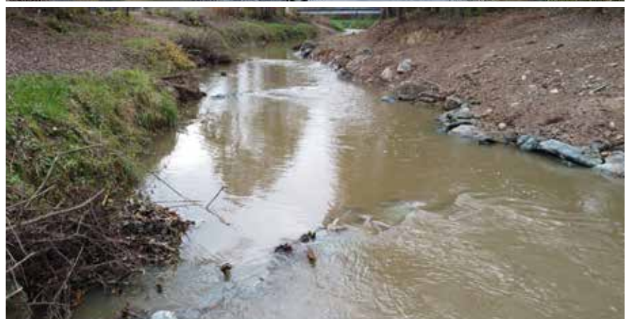
Abb. 22: Der Strukturierungsabschnitt Pöllauer Safen kombiniert mehrere Maßnahmentypen und Baustoffe. Die Bruchsteine für den Buhnenbau wurden der Gleituferböschung entnommen © IB Parthl
