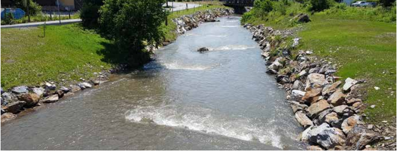
Abb. 2: Bei Mittelwasserführung überströmte Lenkbuhnen in wechselseitiger Anordnung, HWS Kainach, Voitsberg © IB Parthl
