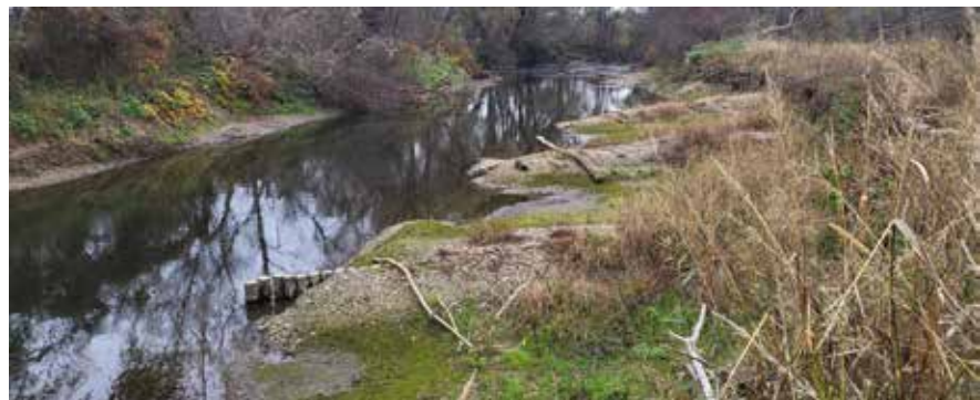
Abb. 16: Sanierung eines rechtsufrigen Uferanrisses an der Kainach/Höhe Weitendorf mittels vorgelagerter inklinanter Buhnen aus Holzpiloten und ausschlagfähigen Gehölzen im oberen Böschungsbereich (vorher oben, nachher unten) © IB Parthl
