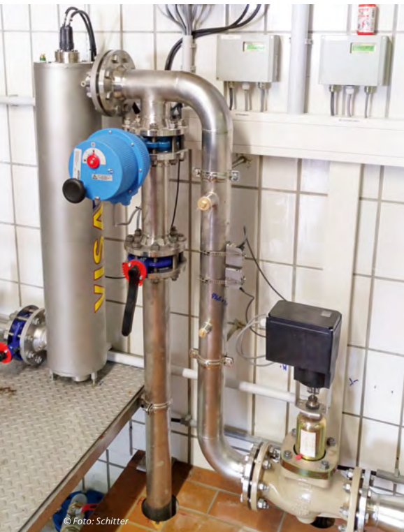
Beispiel einer installierten UV-Anlage
