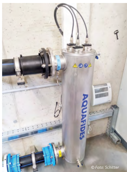
Beispiel einer installierten UV-Anlage
