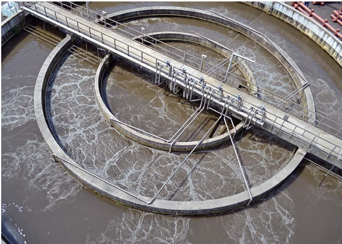
Reinigung des Abwassers in einem Belebungsbecken © Mürzverband
