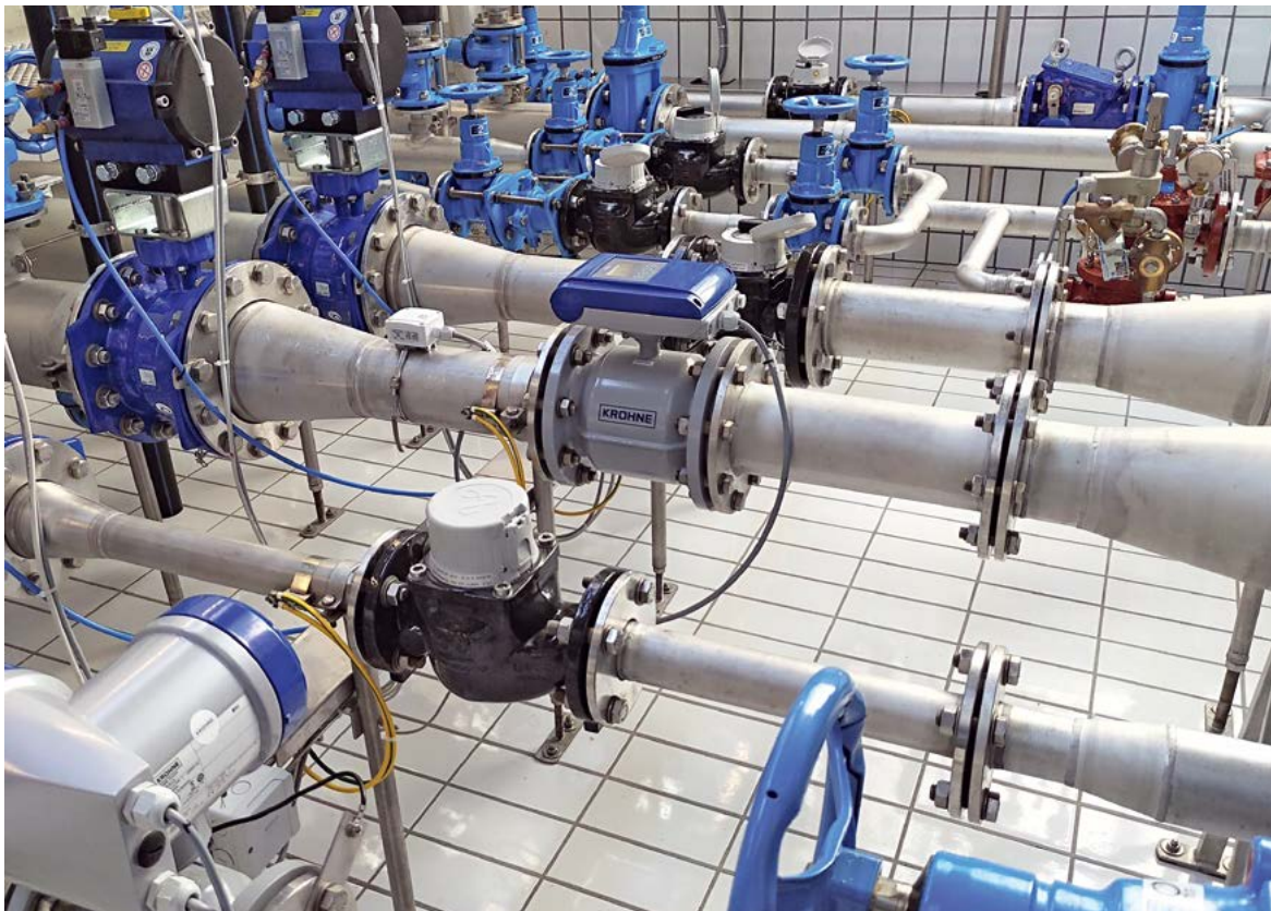
Die Trinkwasserversorgung erfolgt qualitätsgesichert mit Anlagen auf neuestem Stand der Technik © A14
