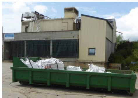
Container mit Asbestabfällen, Quelle: A2Conseils spr
