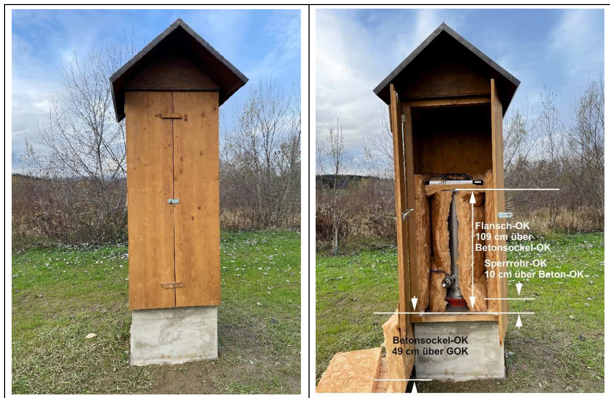
Abbildung 5.17: TGWM Auboden – Messhütte und Pegelabschluss (23.11.2022).
