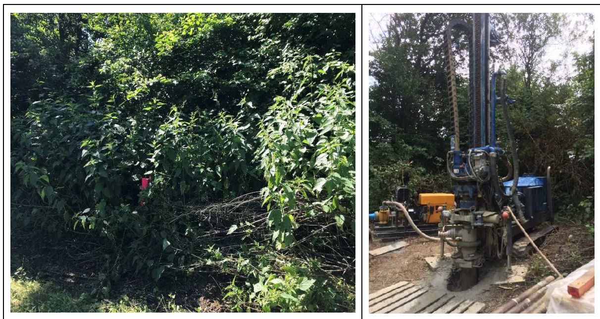
Abbildung 4.22: TGWM Perlstein - links: Ansatzpunkt. rechts: Bohrstelle.
