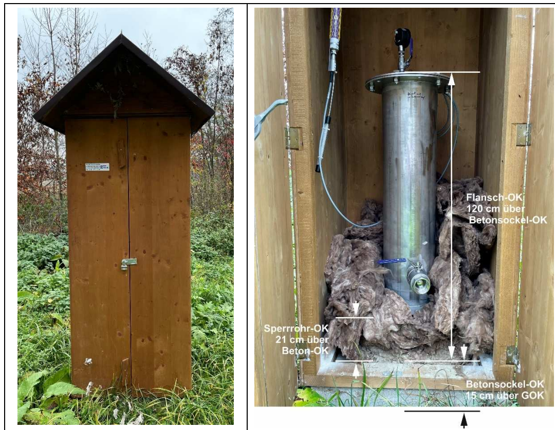
Abbildung 4.13: TGWM Breitenfeld – Messhütte und Pegelabschluss (16.11.2022).
