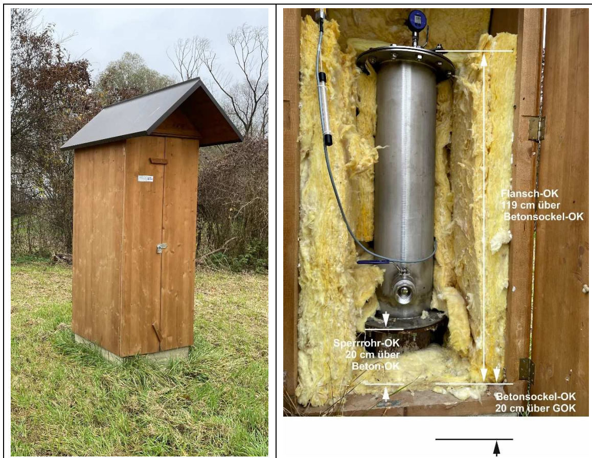
Abbildung 4.28: TGWM Hohenbrugg – Messhütte und Pegelabschluss (16.11.2022).
