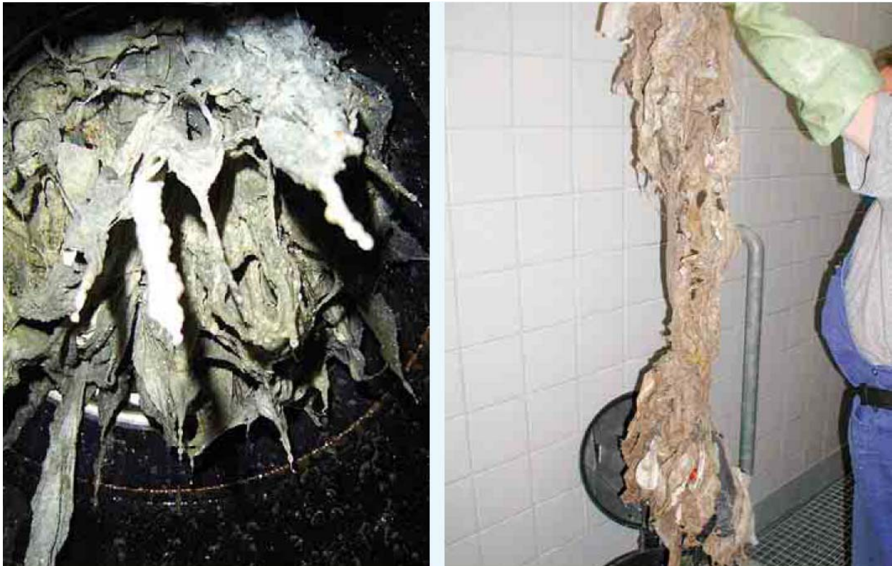
Abbildung 10 – Laufradverstopfung einer Abwasserpumpe (linke Abbildung) bzw. Verstopfungsszenarien durch zopfartige Gebilde (rechte Abbildung) (KRÖBER, 2010)
