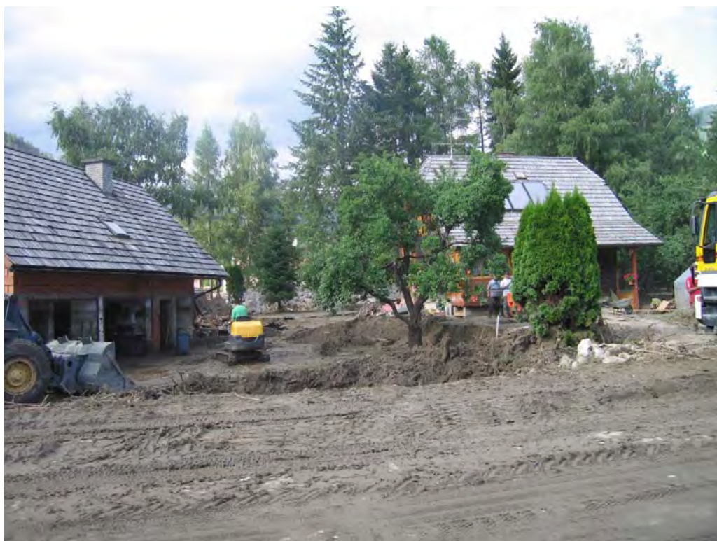
Abbildung 44: Verschlammung in Oberwölz; Standpunkt Greimerstraße; Blick Richtung Norden (Foto Hydroconsult HW_168)
