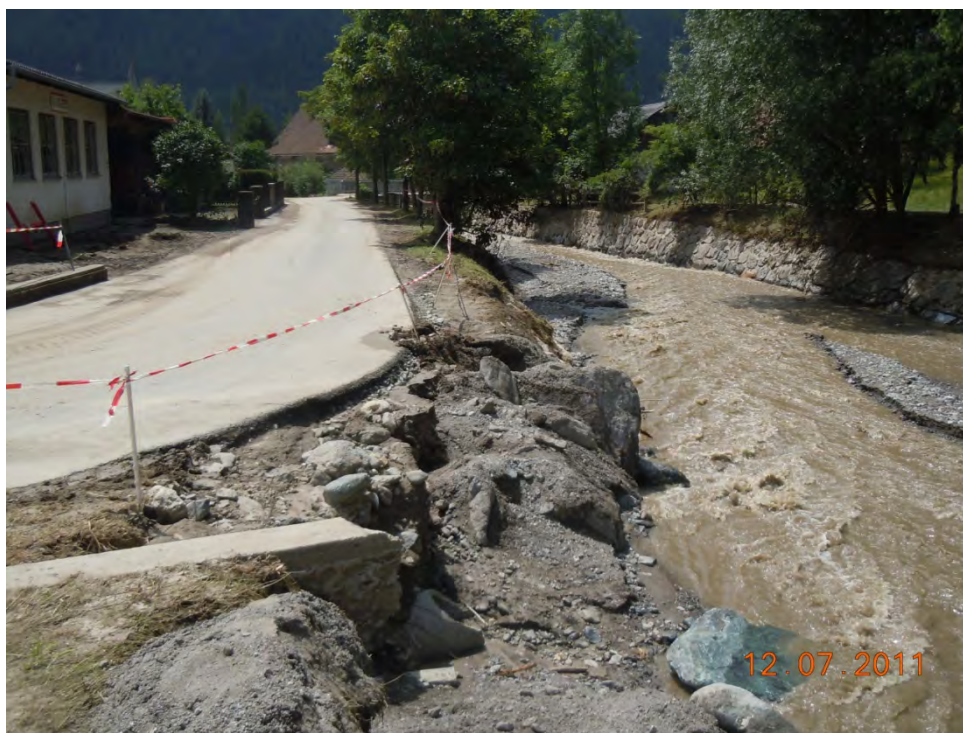
Abbildung 42: Schöttlbach in Oberwölz; beschädigte Uferböschung (FA19B HWS_Wölzertbach_Winklern_115)
