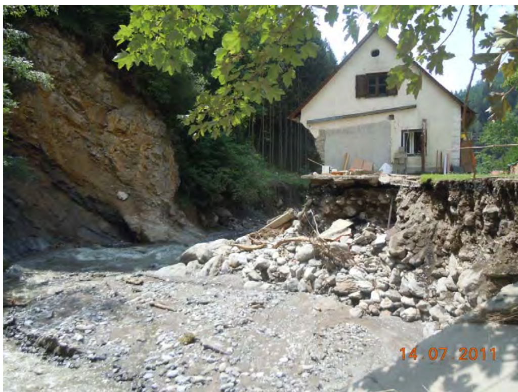
Abbildung 35: beschädigter Uferbereich Schöttlbach; Bereich WLW unter der Sperre (Foto FA19B_HWS Wölzerbach_Winklern 179)
