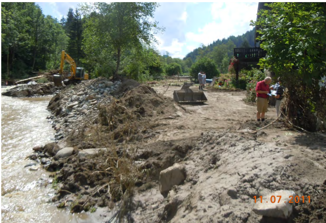
Abbildung 33: Aufräumarbeiten am Eselsbergbach in Winklern; (Foto FA19B_HWS Wölzerbach_Winkler 036)
