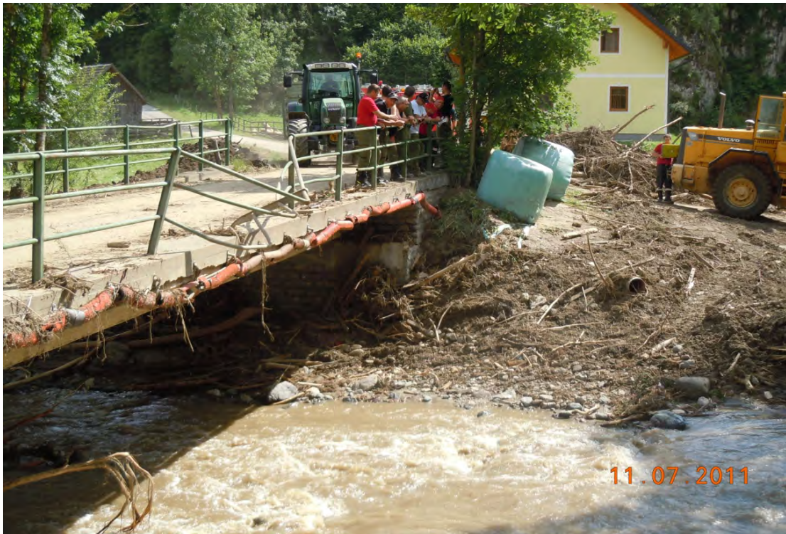
Abbildung 32: beschädigte Brücke in Winklern (Foto FA19B_HWS Wölzerbach_Winklern 051)
