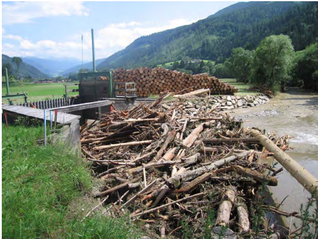
Abbildung 17: Wehranlage Rainer bei km 6.5; Holzablagerungen im Einlaufbereich; (Foto Hydroconsult HW_087)
