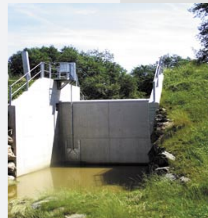
Eingestautes Rückhaltebecken vom Hochwasserereignis 18. Juni 2008
