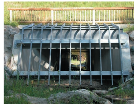
Gesteuerter Grundablass durch den Erddamm. Er schließt, wenn das Wasser in Ehrenhausen steigt.
