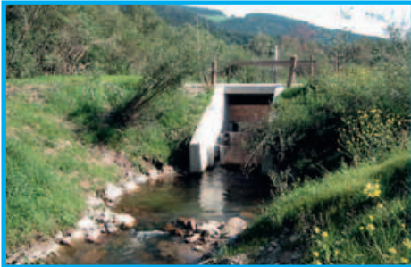
Bauwerk für das Fischaufstiegsgerinne
