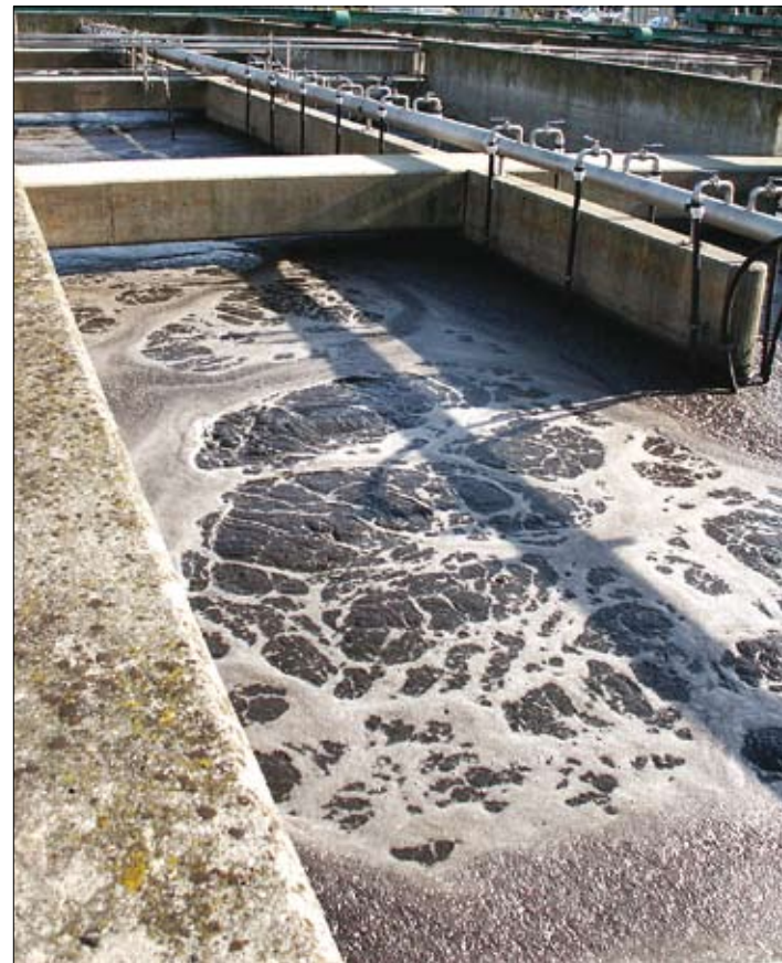
Abb. 2: Kläranlage Graz in Gössendorf (Fotos: W. Spätauf)
