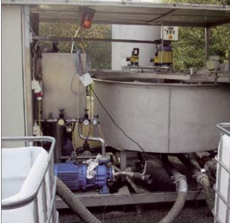
Abb. 3: Pilotanlage zur weitergehenden Reinigung der Abwässer aus der Lederfabrik.
