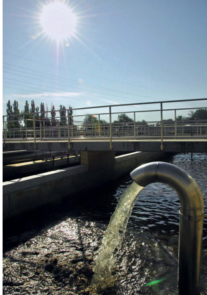
Biologische Stufe der Abwasserreinigungs- anlage
