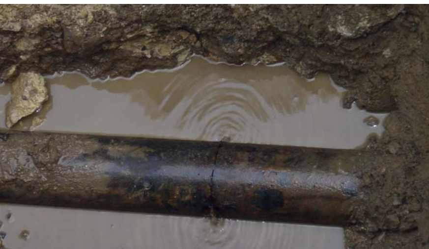
Trinkwasserleitung mit Rohrbruch
