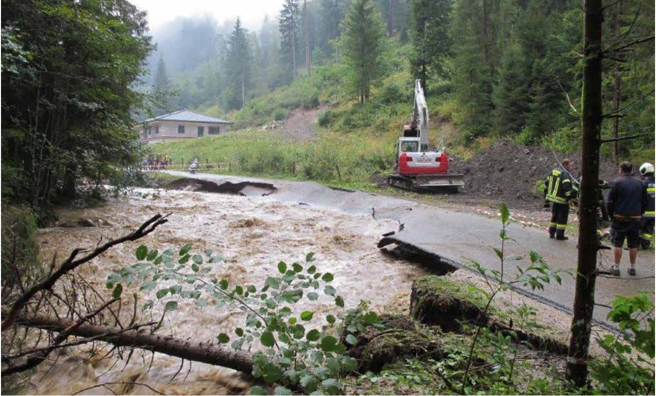
Abb. 6: Unterspülte Gemeindestraße und Ausuferung der Lavant © BBL OW
