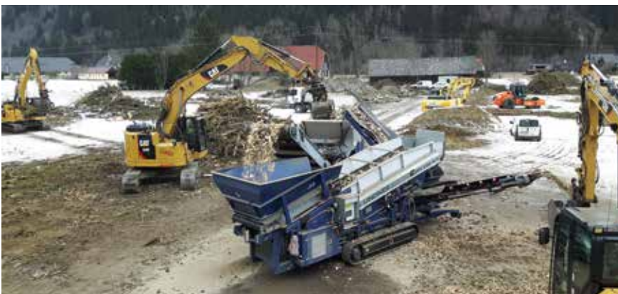
Abb. 13: Urlbach, Gemeinde Stadl-Predlitz, Aufräumarbeiten © WLV
