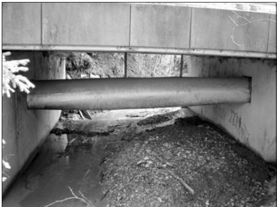
Weizbach - Brücke Franz Werfel-Gasse: Ein nicht alltägliches Abflusshindernis!
