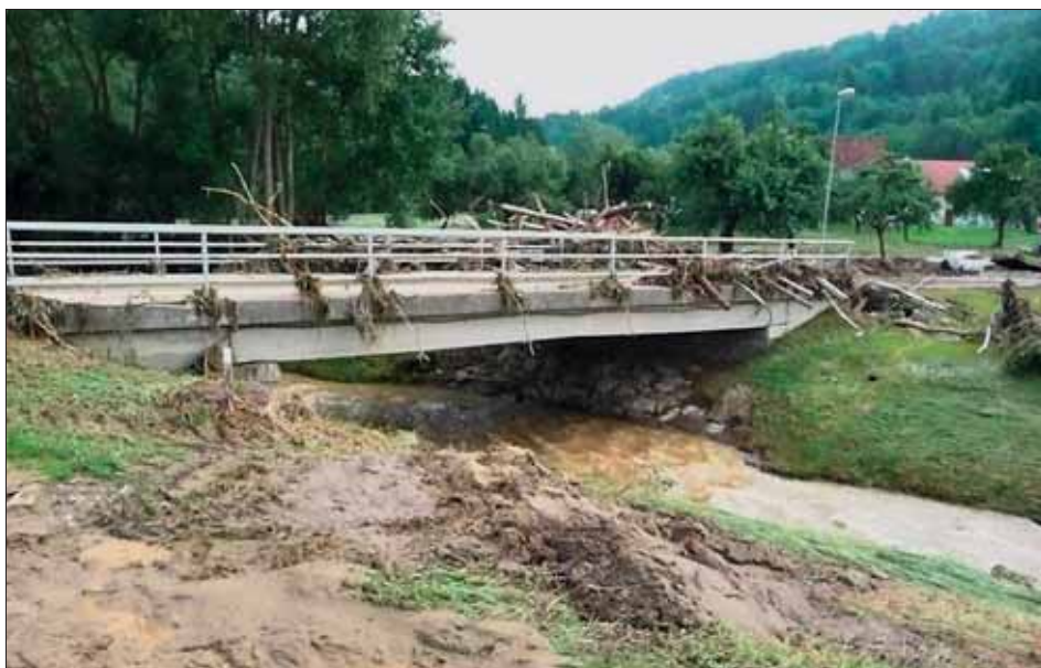
Abb. 1: Tauchenbach in Laufnitzdorf nach Abklingen des Hochwassers am 14. Juni 2010
