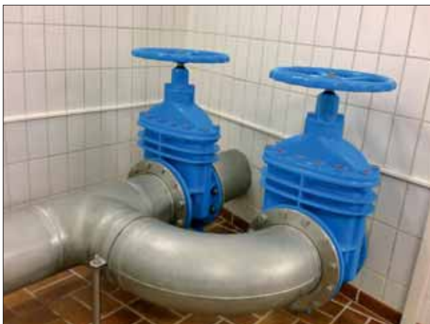
Abb. 5: Wasser aus der Transportleitung wird in örtliche Wasserleitungen eingespeist
