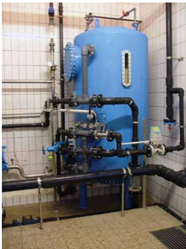
Abb. 5: Wasseraufbereitungsanlage der Wassergenossenschaft Bad Gams
