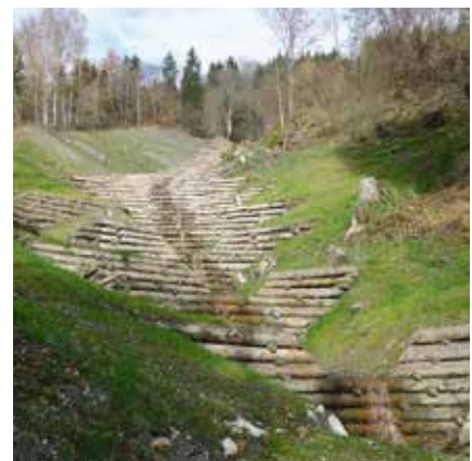
Abb. 8: Pöllingergraben: Stadtgemeinde Trieben, Gerinnesicherung mit Holzquerwerken
