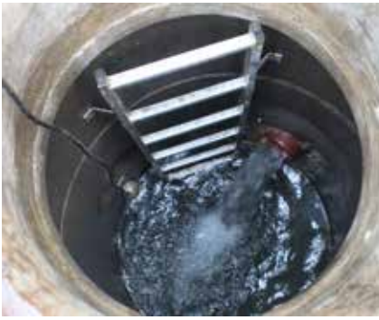
Abb. 2: Unerlaubte Einleitung aus einer Grundwasserdrainage © AWW Grazer Feld
