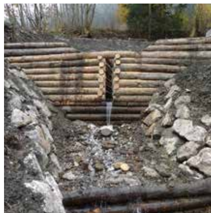
Abb. 7: Lorenzerbach: Stadtgemeinde Trieben, einfaches Ausschotterungsbecken
