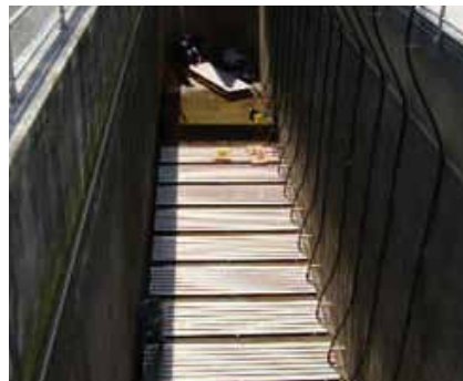
Membranbelüfterplatten in den Belebungsbecken
