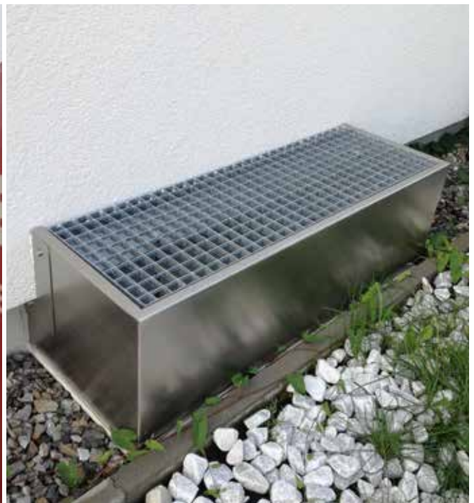
Erhöhter Lichtschacht schützt vor einem Wassereintritt © Lederer
