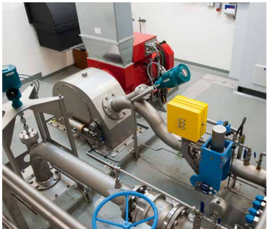
Trinkwasserkraftwerk im Hochbehälter Maria Lankowitz © Stadtwerke Köflach
