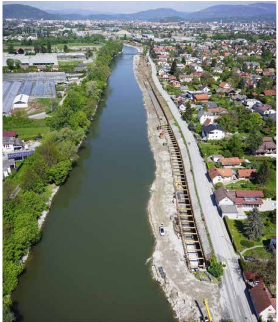
Abb. 1: Zentraler Speicherkanal – Luftbild © Holding Graz
