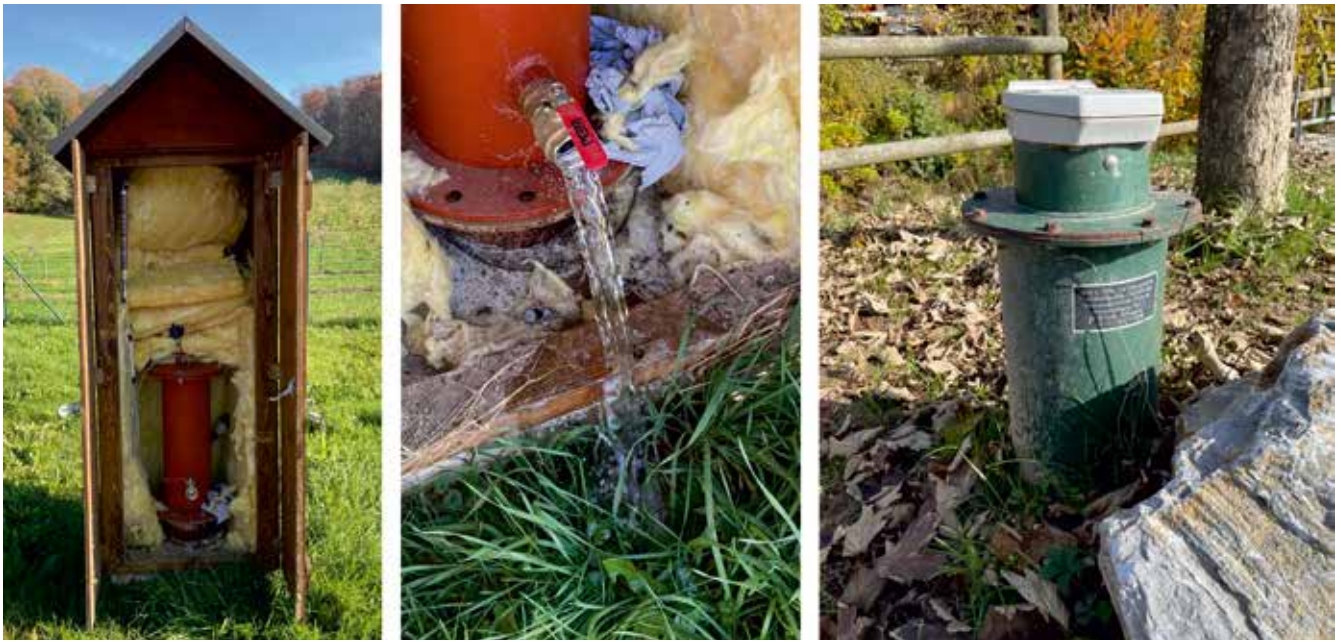
Abb. 2: Beispiele von Tiefengrundwassermessstellen (links und Mitte: artesisch, rechts: unterhydraulisch) © Aquifer GmbH
