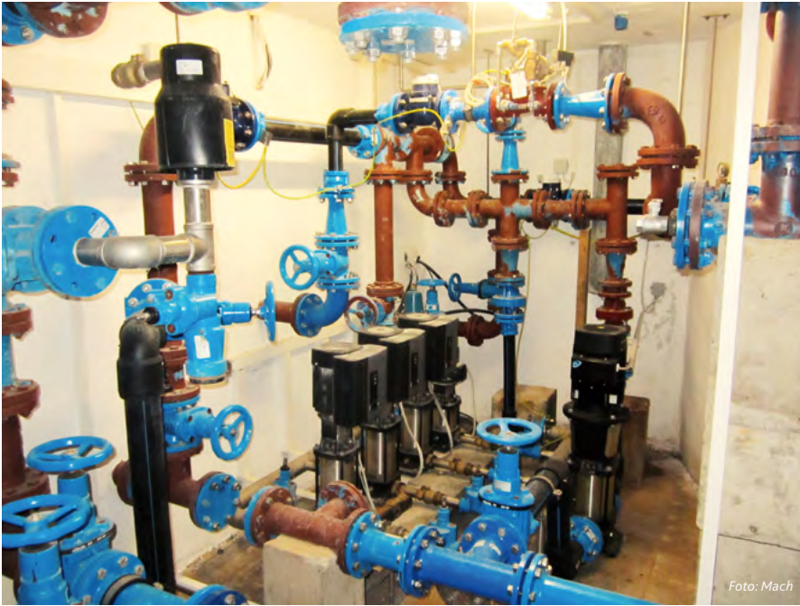
Beispiele von Armaturen in der Wasserversorgung
